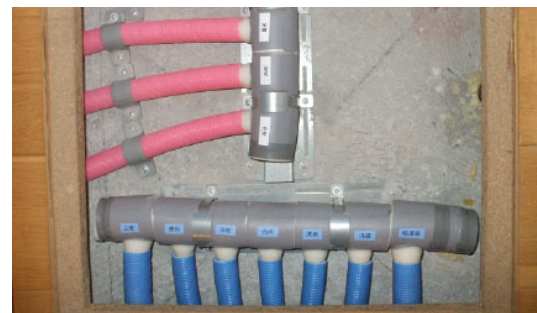
ヘッダー配管
